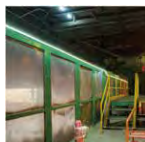
手すりの照明
